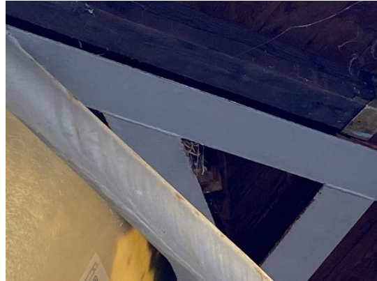
Foto 15: Unterbau Siloanlage, Träger mit Vogelnest
