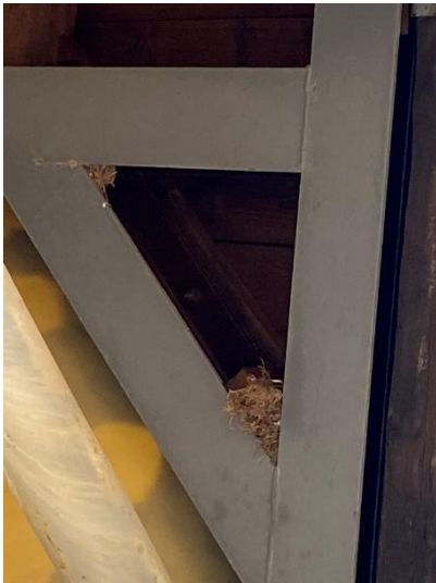
Foto 14: Unterbau Siloanlage, Träger mit Vogelnest
