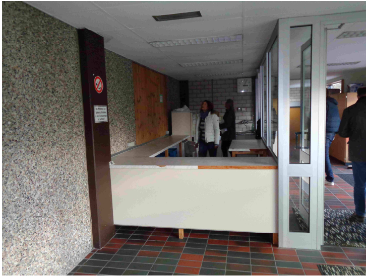
Teeküche mit Provisorien und defekten Arbeitsplatten
