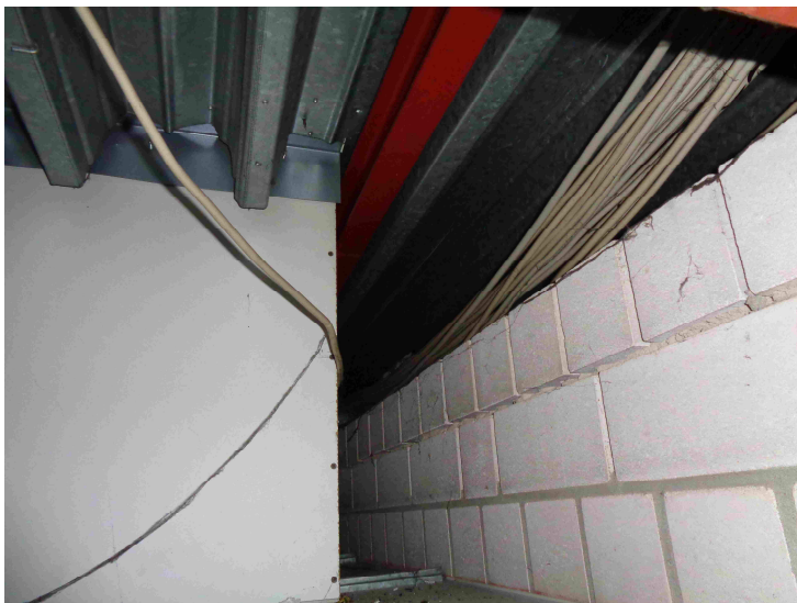
Die Stabilität der Kalksandsteinwände speziell im Flurbereich ohne oberen Ringgurt muss noch untersucht werden.
